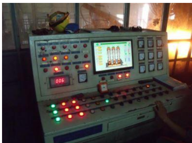
Sistema de controle.
