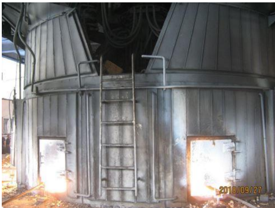
2 conjuntos de fornos de silicone concluídos e colocados em produção em 2010
