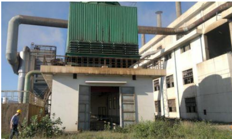
SQC Sala de bombas de agua del horno de escoria de titanio en la escena
